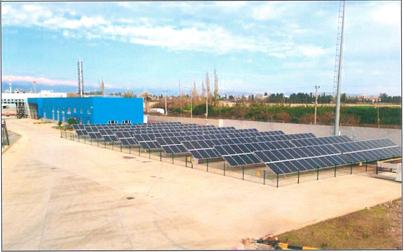
Şekil 3: Örnek Güneş Enerji Santrali-2
